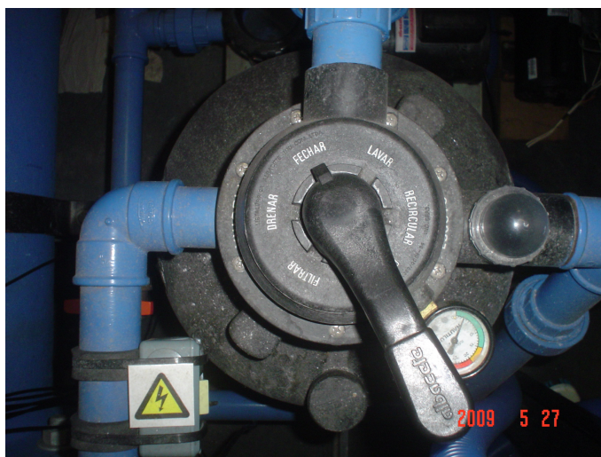
Figura 3.3: Posição da válvula para drenagem do canal
